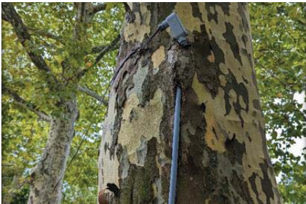
Exterior lighting conduit
